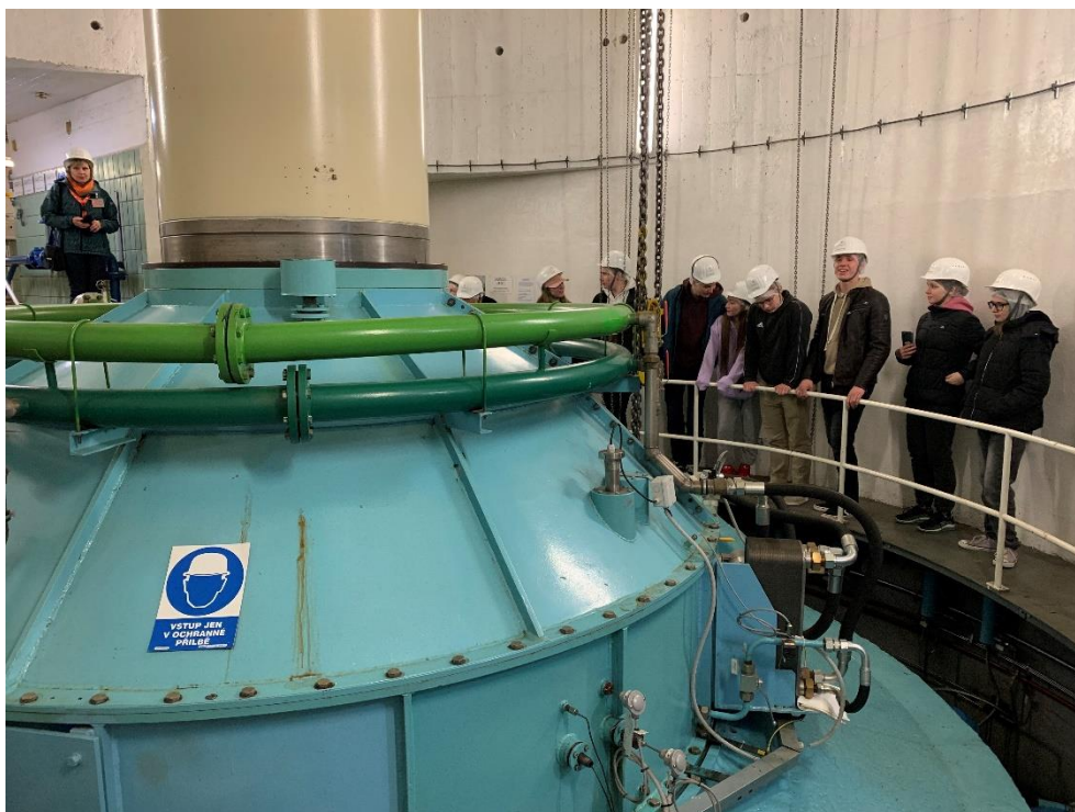
Exkurze do přečerpávací vodní elektrárny Dalešice
